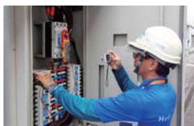
ACP盤檢查 - 電壓電流量測 Inspection ACP - IV Measurement
